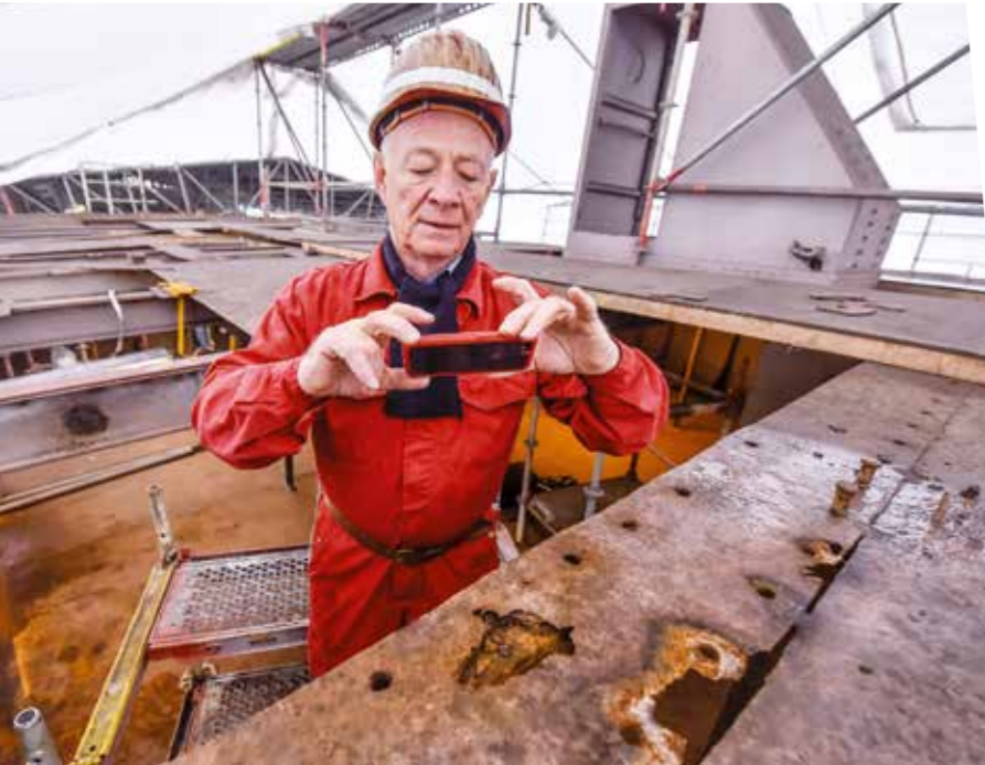
DOKUMENTATION: Joachim Kaiser fotografiert Rostschäden im Heckbereich.
