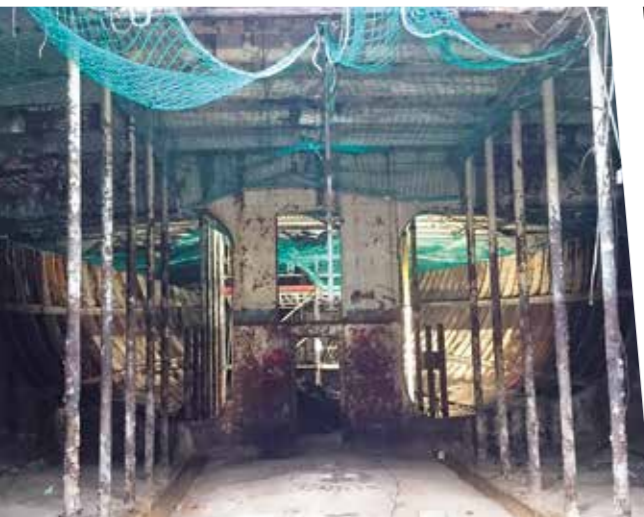
MARODE: Ein Blick in das Innere des Windjammers, nachdem der Laderaum leer geräumt worden war.
