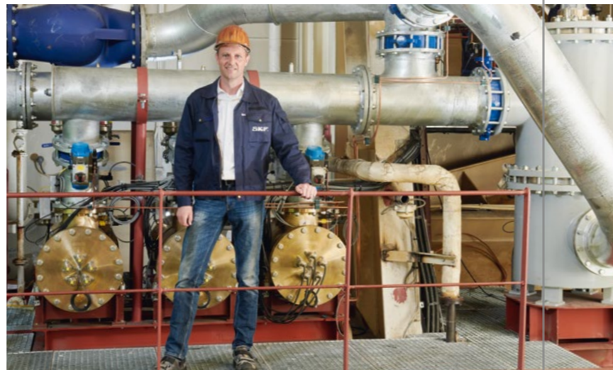
Vor der fertig installierten BlueSonic-Anlage: Mathias Rusch, Direktor des Geschäftsbereichs Marine bei SKF.
